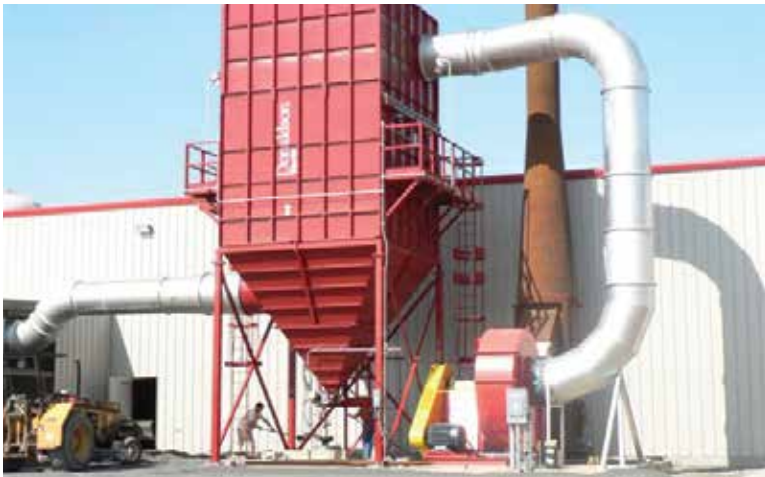
324MBWS10 en Instalación de Manufactura de Vidrio
